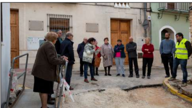
C/ del Cup, Sant Joan Bta., Jaume I, la Safor, i Aigüera Substitució del fibrocement i pavimentació - 274.293,35 €
